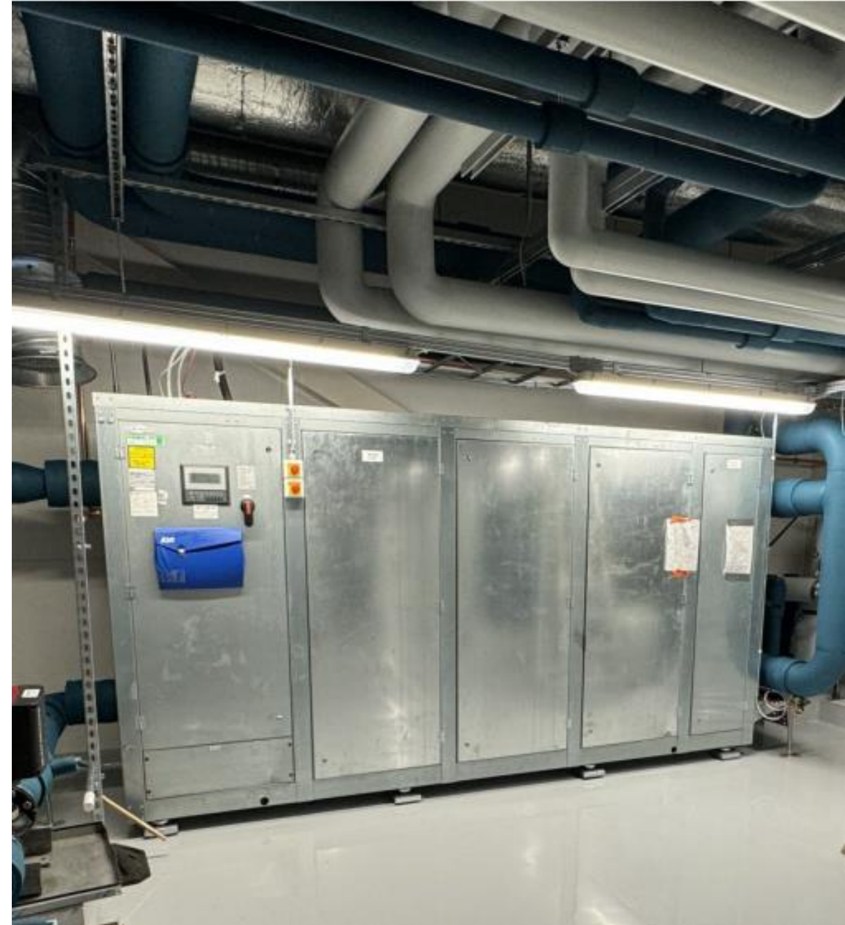
Kuva: Vedenjäähdytyskone asennettuna uudiskohteessa. (Lähde: Ärväs, 2024)
