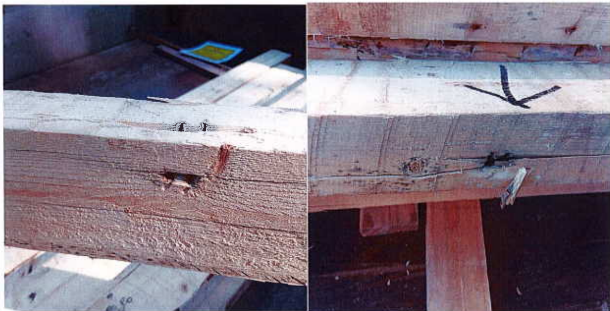
Kuva 6. Naulakiinnitykset syrjän ja lappeen läpi oli suurin yksittäinen käsittelyvaurioiden syy.
